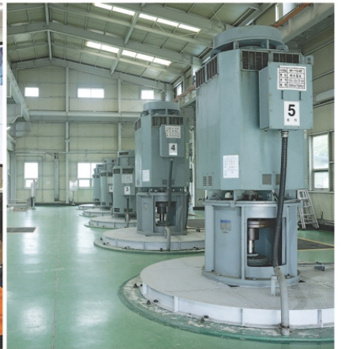
강매 배수펌프장 내부 전경.
